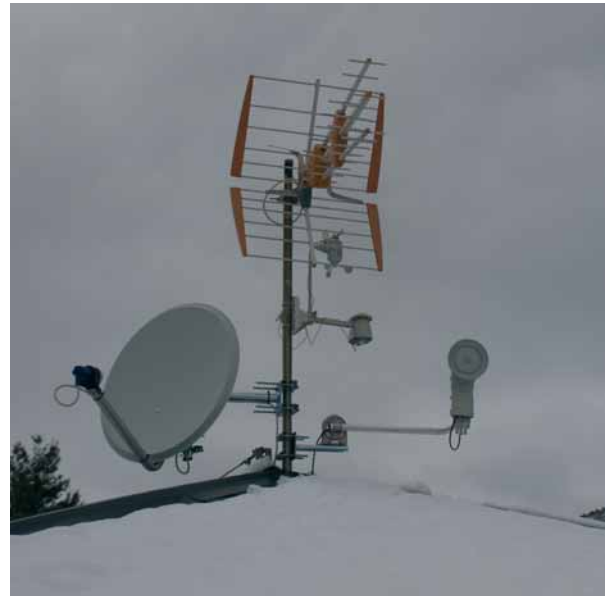
Detalle de la estación meteorológica instalada por IMAT expresamente para este proyecto en la cubierta del edificio objeto del ensayo.
